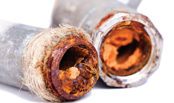
Рис. 2.1. Техническое состояние трубопроводов распределительных сетей.
